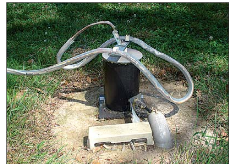
Bild 7: Fußpunkt mit PVC-Rohr als Isolator, Potenzialausgleichsschiene für die Radials, aus der Erde (HT-Rohr) kommendem Koaxialkabel und Kabelbuchten Fotos: DK6ED
